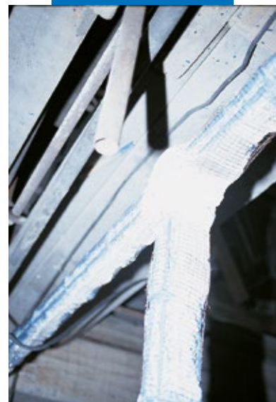
Estructura de concreto deteriorado
